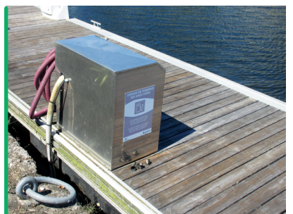
pompes à eaux noires (port de Morlaix)
